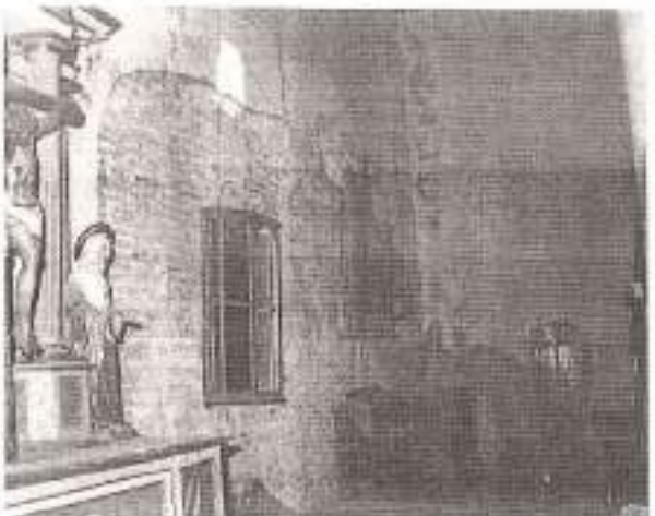
Esta es la fachada de la iglesia. La estructura está bastante deteriorada.
