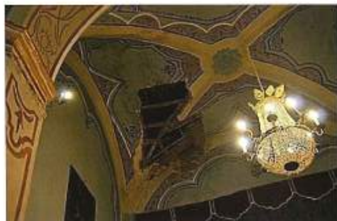
El techo se cae, una de las muestras del grave deterioro del techo de San Matías.
